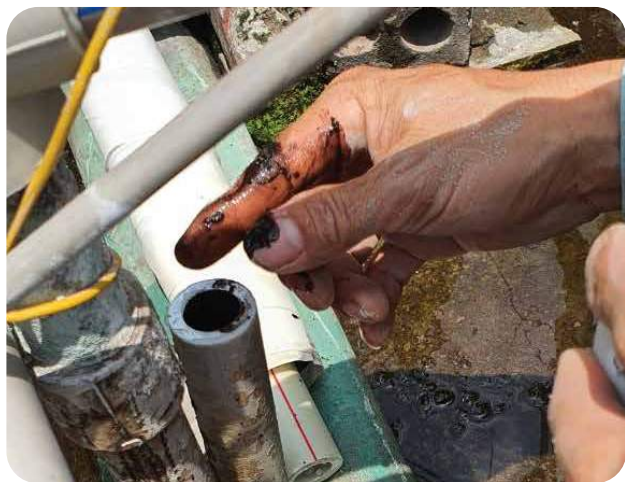
VỠ ĐƯỜNG ỐNG
